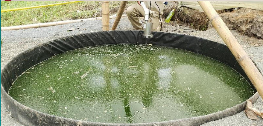
10. Recirculación de los drenados
