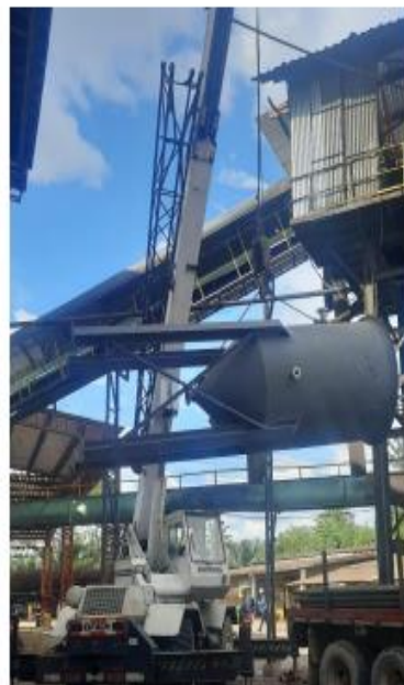
Descarga de tanques
