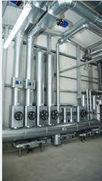
Distribuidores de vapor
